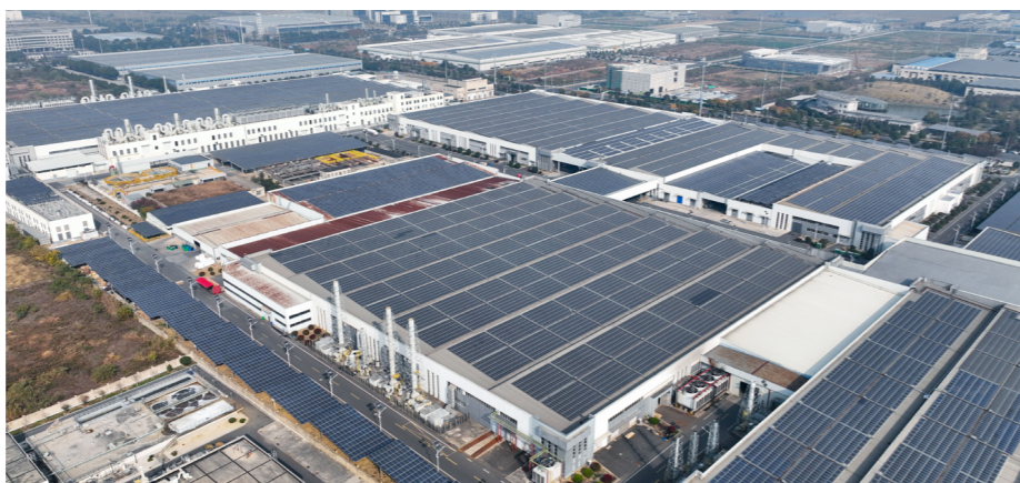
图 4-9：常州亿晶光电科技有限公司屋顶光伏
