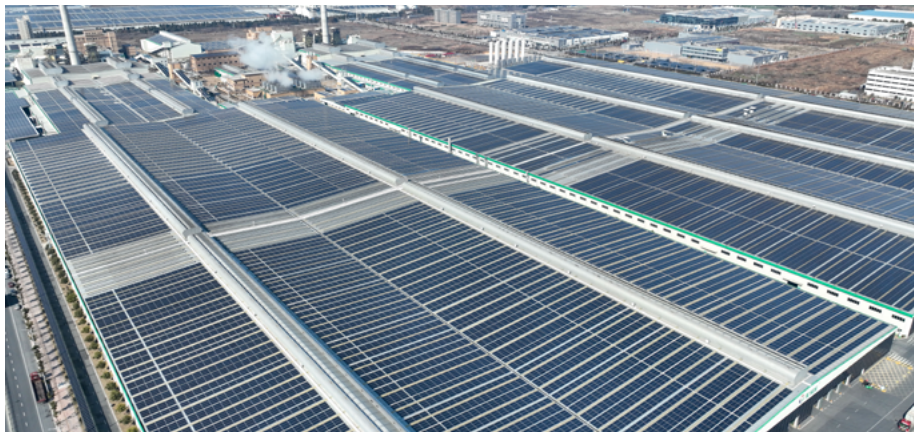
图 4-8：信义光能控股有限公司屋顶光伏 60
